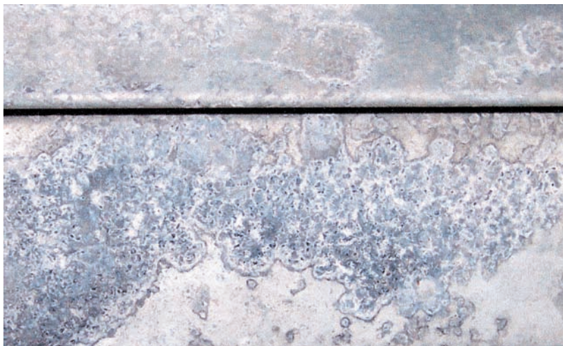
Yta hos varmförzinkad släpvagn där vitrost bildats då den utsatts för vägsalt.
